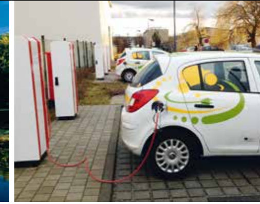
Ladestationen für Elektroautos: Projekt e-SolCar
