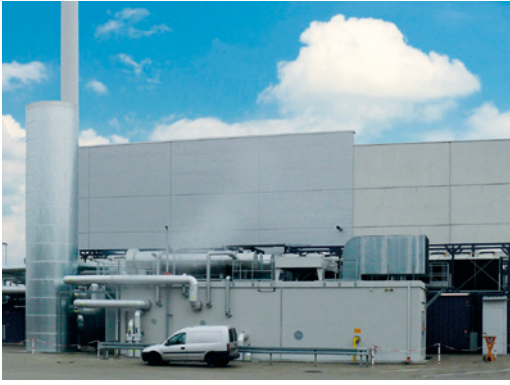
Biomethan-Blockheizkraftwerk von Danpower für die Rotorblattfertigung von Vestas Blades in Lauchhammer
